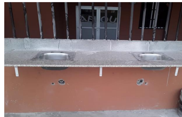
Instalaciones de tina para lavados de mano al ingreso de las instalaciones
